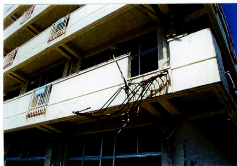
津波で2階ベランダ壁が破損
