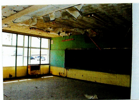
1階は天井まで浸水
